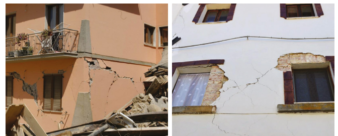
Evidenza di lesioni diagonali nel piano per taglio-trazione
